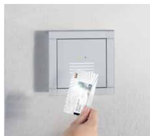
Bedienfreundliche Online-Zutrittskontrolle für den Zutritt ins Gebäude. Die Tür öffnet in Sekunden-schnelle.
